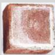
Avec efflorescence (II)
